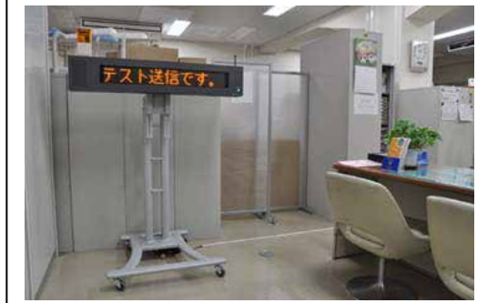
西部保健福祉センターの窓口に設置された受信端末機
